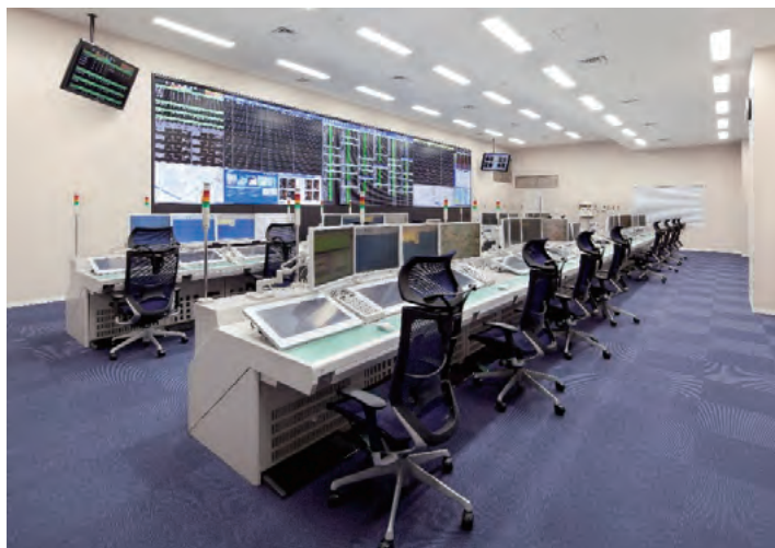
写真8 5階指令管制室
