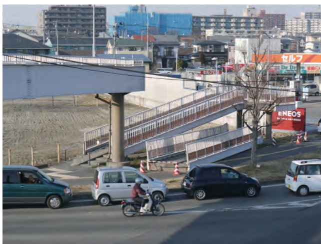
写真3 構造物の落下
