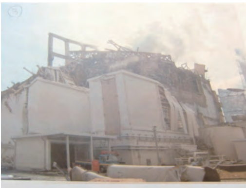
3号機建て屋の状況（事故当時）
