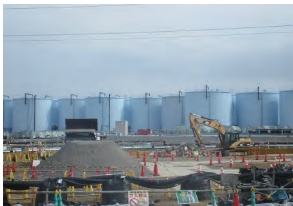
汚染水貯蔵タンク（現在）
